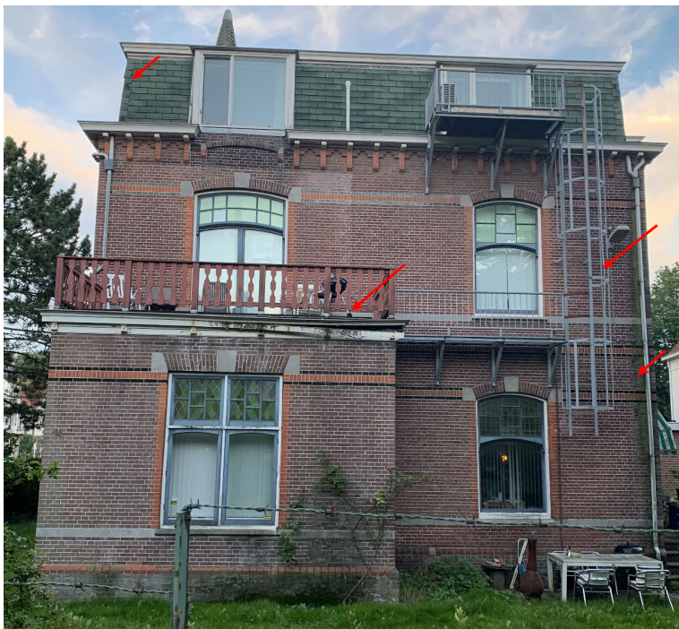
Foto 5: Achteruitgang aan het schilderwerk, losse 'shingles', niet functionerende brandtrap en schimmelvorming aan de muur
