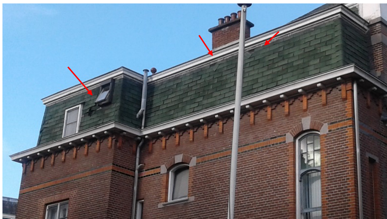
Foto 2: De dakbedekking ('shingles') zijn in slechte staat en laten los
